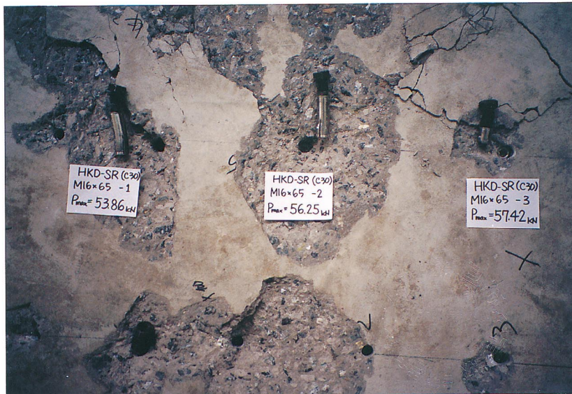
写真-18 試験項目:せん断試験 \sigma_c (N/mm 2 ): 29.3 試験体記号: HKD-SR M16×65-1~3 [試験体の状況] 複合破壊
